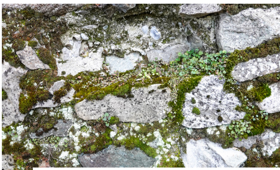
Joints à base de chaux colonisés par des mousses et des lichen en Suisse | © Hélène Burgisser Hinden
