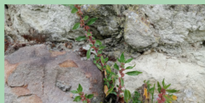
La pariétaire ( Parietaria judaica ) se développant au niveau d'un joint de mur I © Maxime Dépino, Plante & Cité
